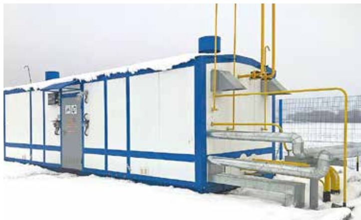
Блочная станция ГРС Наумовка снаружи...
